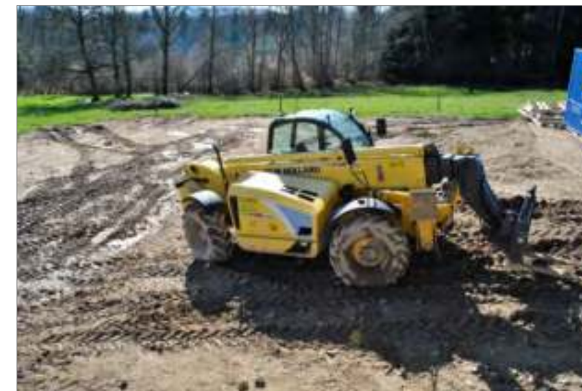
Photographie 58 : Exemple de tassement et d'ornières créés par les engins de chantier
