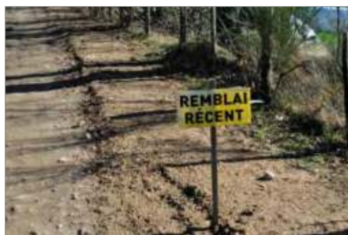
Photographie 59 : Exemple de remblai des tranchées électriques le long d'une piste (Source : ENCIS Environnement)
