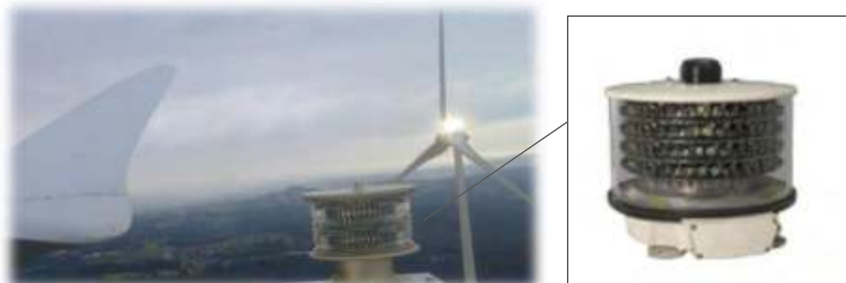
Figure 61 : Balisage d'une éolienne
